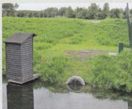
▲ Links de plonsplee met daarnaast de inlaat van de hulpbemaling (foto 16 augustus 2015).
