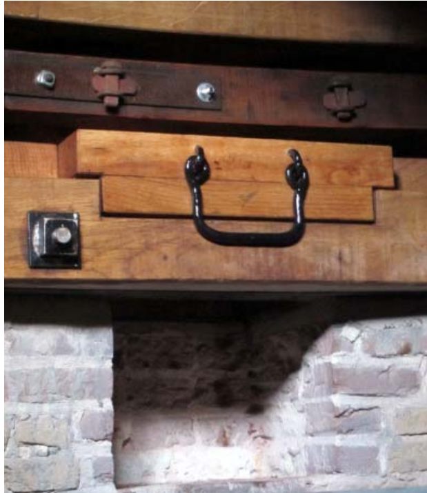
Afb. 21. De vernieuwde rollensluis naar oud model: onder de ruimte om rollen te wisselen, daarboven de muurplaat en daar weer boven de slijtplaat met uitneembaar gedeelte. (Foto auteur, 31 januari 2014)
